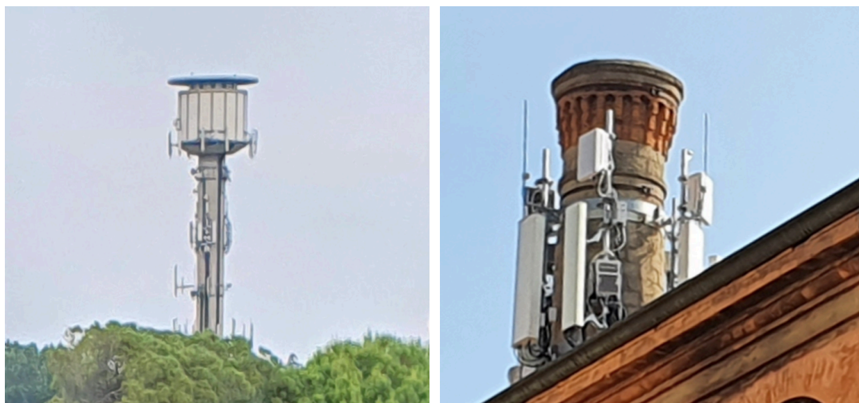
Figura 4: esempi di SRB installate
