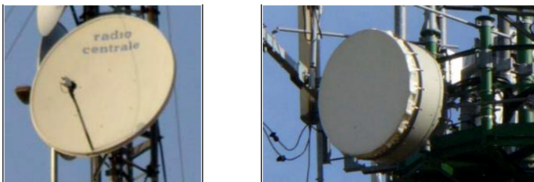
Figura 8: esempi di ponti radio di antenna radio e di ponte radio di Stazione Radiobase
